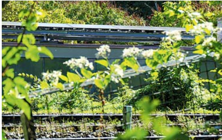
Der sichtbare Teil der Photovoltaik-Anlage des Nashornhauses, vom Weg um das Antilopenhaus her. Fotos: Philip Karger
