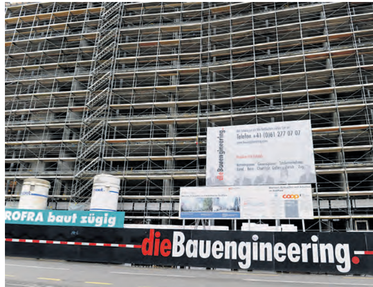
An der Meret Oppenheim-Strasse entsteht ein «Gundeli-Manhattan». Der Rohbau des Grossprojektes «Südpark» (zwischen Güterstrasse und Meret Oppenheim-Strasse) ist fertig. Mehr dazu auf den Seiten 1-4. Foto: J. Zimmermann.
